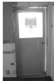
写真 1 防火扉の被害例 (東日本大震災、仙台市内の共同住宅)
