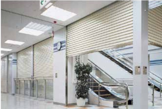
縦穴区画の防火 / 防煙シャッター
